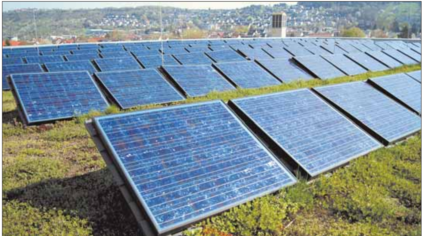
Die Kraft der Sonne fängt „S.U.N.“ mit seinen gemeinschaftlich gebauten Fotovoltaikanlagen (wie hier auf dem Auguste-Pattberg-Gymnasium in Mosbach-Neckarelz) ein. Seit 15 Jahren findet der Verein immer mehr Freunde der Sonne. Fotos: Heiko Schattauer/privat
